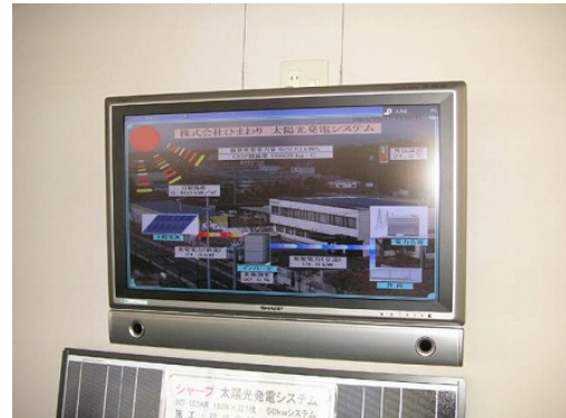
【発電システム監視モニ】
