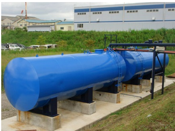
【雨水貯水タンク】
